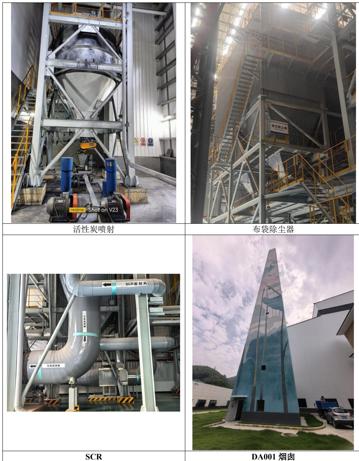
图 4.1-1 焚烧炉废气 (DA001) 处理设施照片
