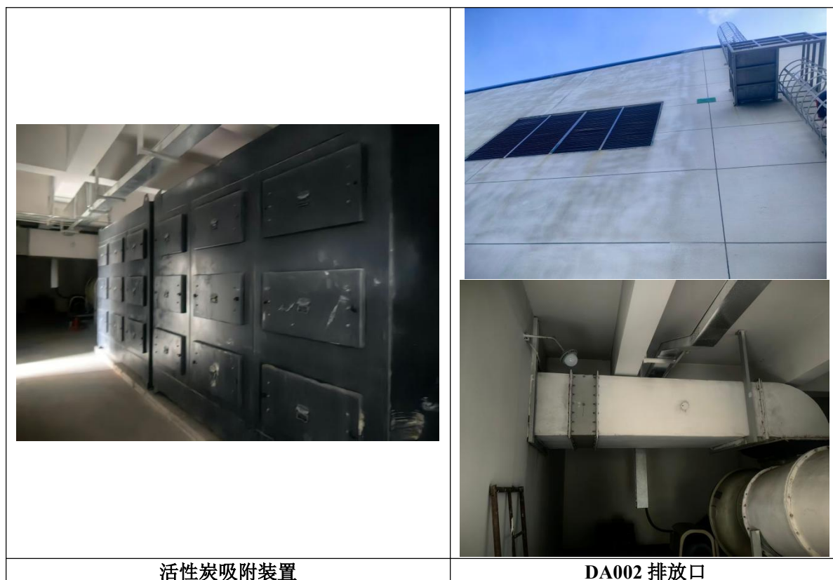
图 4.1-2 停炉检修时恶臭废气（DA002）处理设施照片
